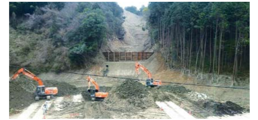
▲大沢町牛滝川土砂流出場所の状況
