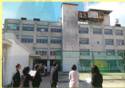
▲ 屋上に残る使わなくなった空調装置 (東淀川支援学校)
